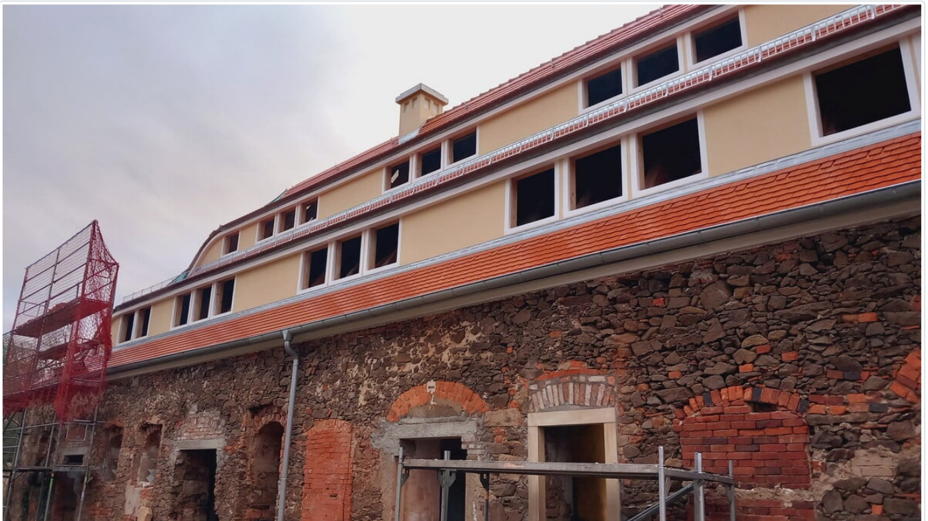
Über dem ehemaligen Pferdestall entstehen die ersten Ferienwohnungen. Das Dach ist in diesem Jahr aufwendig erneuert worden. © Jörg Richter
