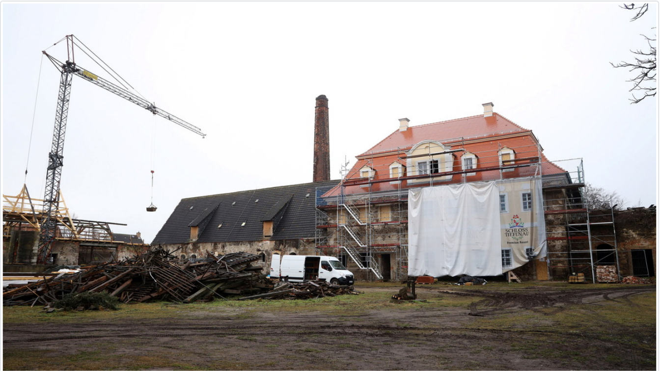
Das Dach auf dem westlichen Torhaus ist im vergangenen Jahr mithilfe heimischer Firmen rekonstruiert worden. © Sebastian Schultz
