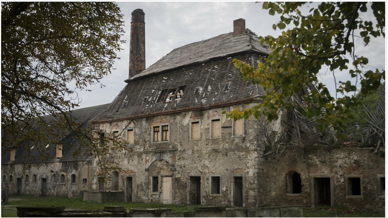
Das Dach des hinteren Torbogenhauses ist seit diesem Jahr abgedeckt. Dasselbe gilt für das Dach der benachbarten ... © Eric Weser
