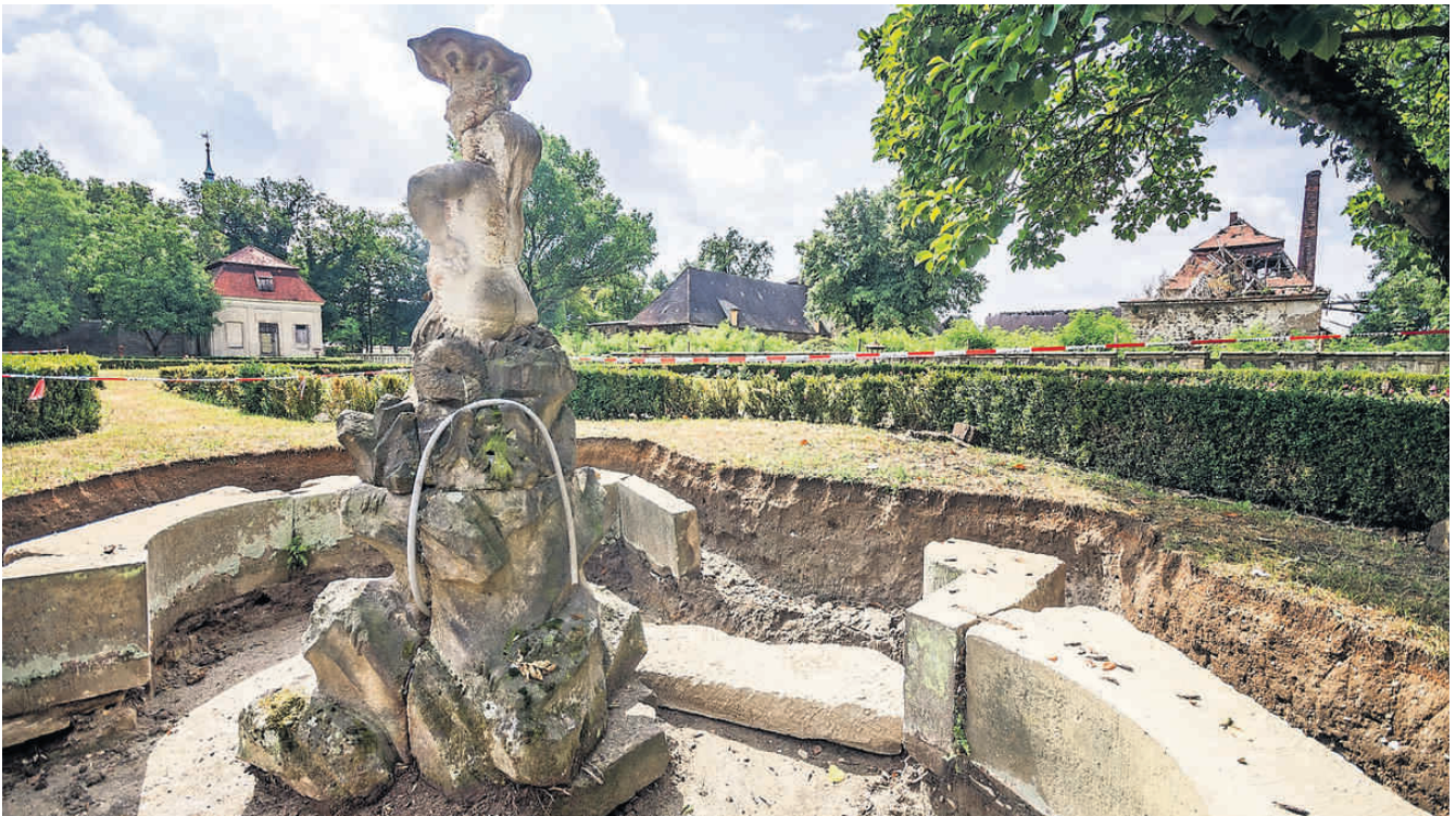
So sahen die Brunnen vorigen Sommer – vor der Sanierung – aus. © Eric Weser
